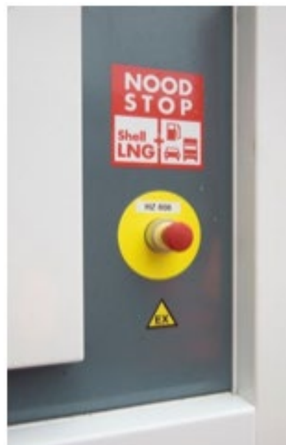
◀ Arrêt d'urgence sur la borne de distribution
